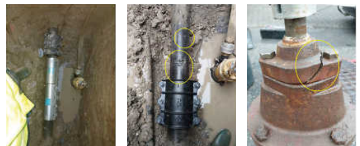
Provisorisch repariert Provisorisch repariert Kaputter Schieber und weitere Schäden
