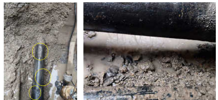
Rohrbruch und weitere Schäden am Rohr
