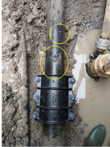
- Provisorisch repariert und weitere Schäden
