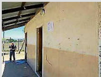
WC Trakt mit austretendem Wasser
